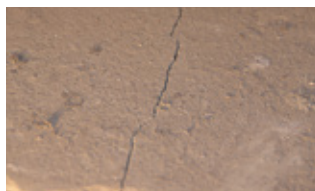
Стяжка с трещинами
