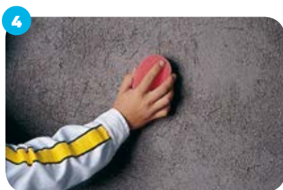
4 Удалить вещества, ухудшающие адгезию – жир, пыль и т. п. Основа должна быть сухой. Проверить адгезию слоя краски к основанию и удалить отслаивающуюся краску.
